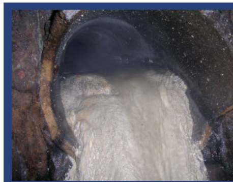
La tubería de servicio de aguas residuales, conectada a un restaurante de San Francisco, está atorada por FOG.
