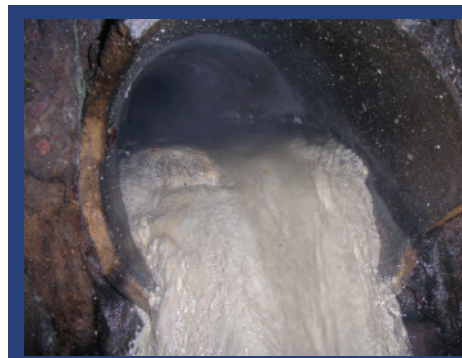
被FOG堵塞的污水系統分支管道，管道與舊金山一家餐館相連。
